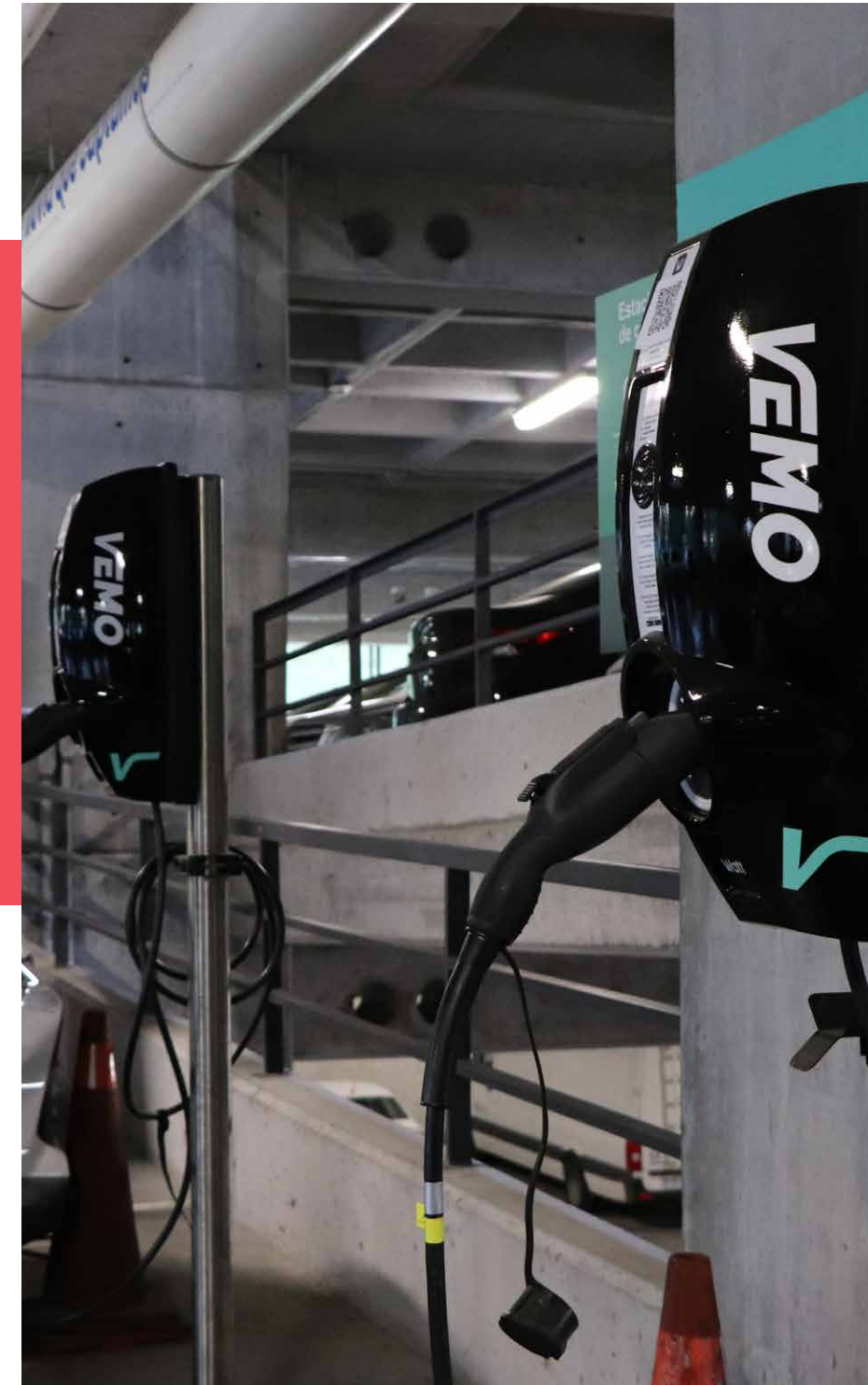
Cargadores eléctricos en E2 - Off Grid
